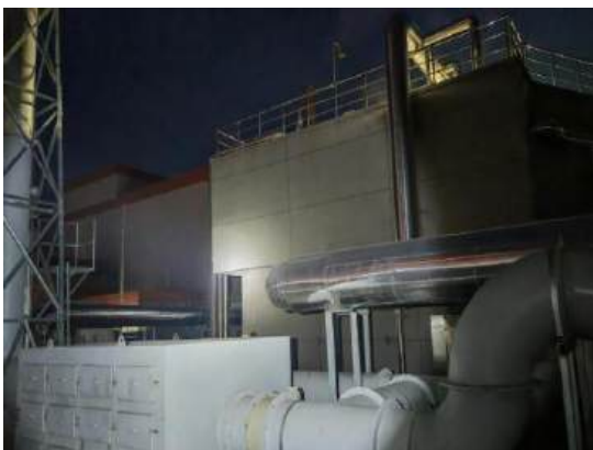
渗滤液处理站臭气处理系统
