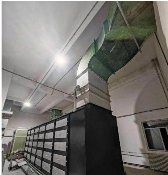
垃圾储坑除臭系统
