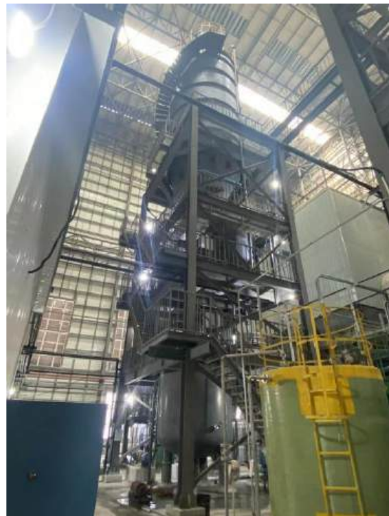
熟石灰仓及仓顶布袋除尘器
