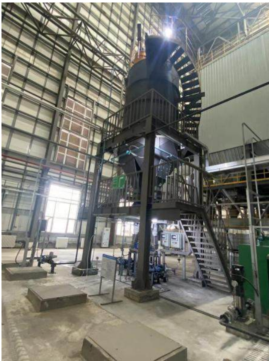
活性炭仓及仓顶布袋除尘器
