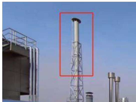
15m 高排气筒
