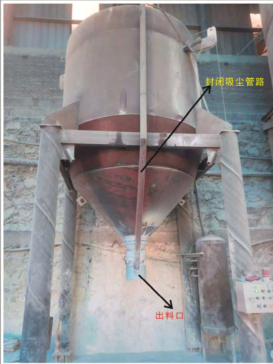
图4-2 设备自带封闭吸尘管路示意照片
