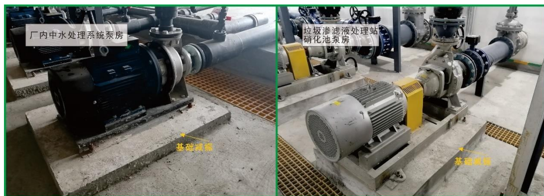
图 2.4-6 现有项目噪声治理设施实际建设情况图
