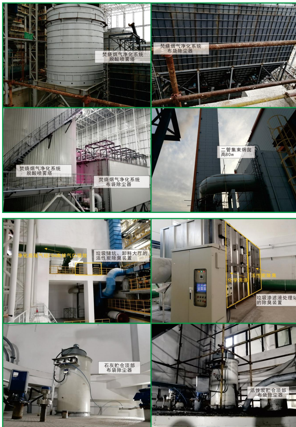
图 2.4-5 现有项目废气处理设施现场照片
