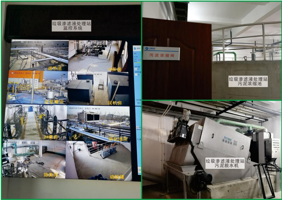
图 2.4-2 现有项目废水处理设施现场照片
