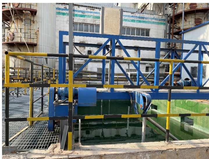
图 7.2-3 现有工程废水处理系统现状
