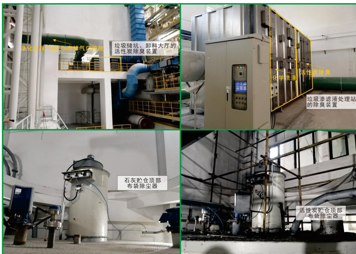
图 4.5 项目废气处理设施实际建设情况图
