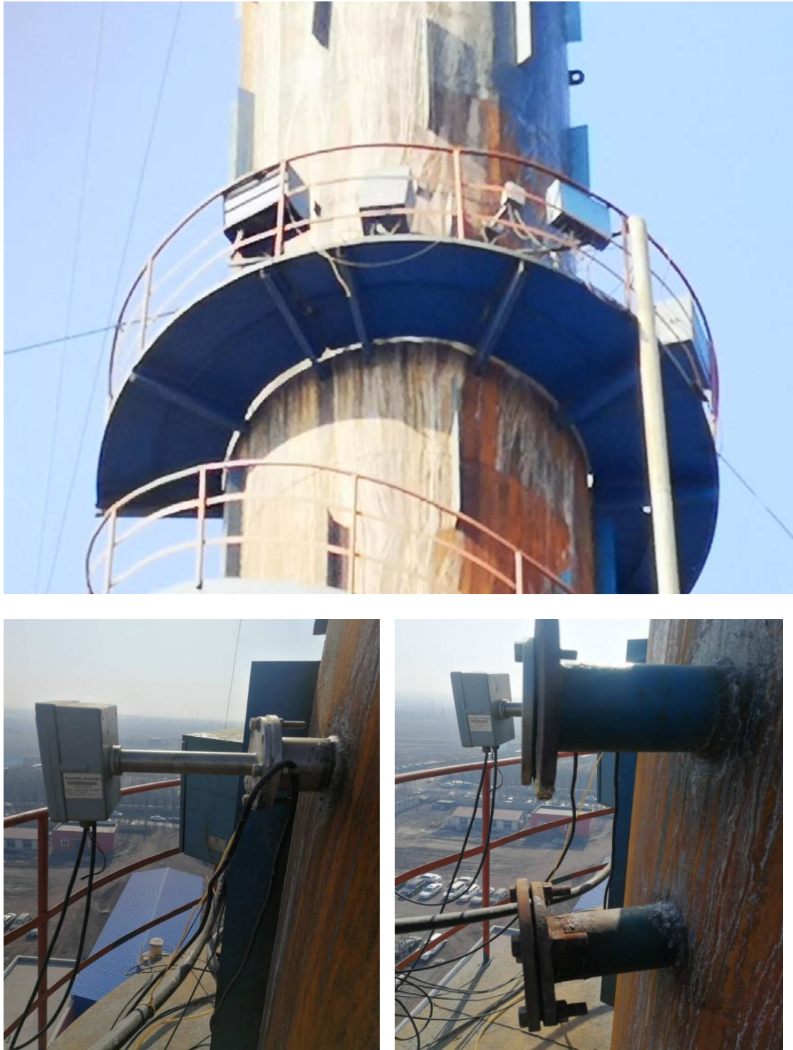
图 4.2-4 锅炉烟囱（锅炉烟气出口）监测平台及采样孔照片
