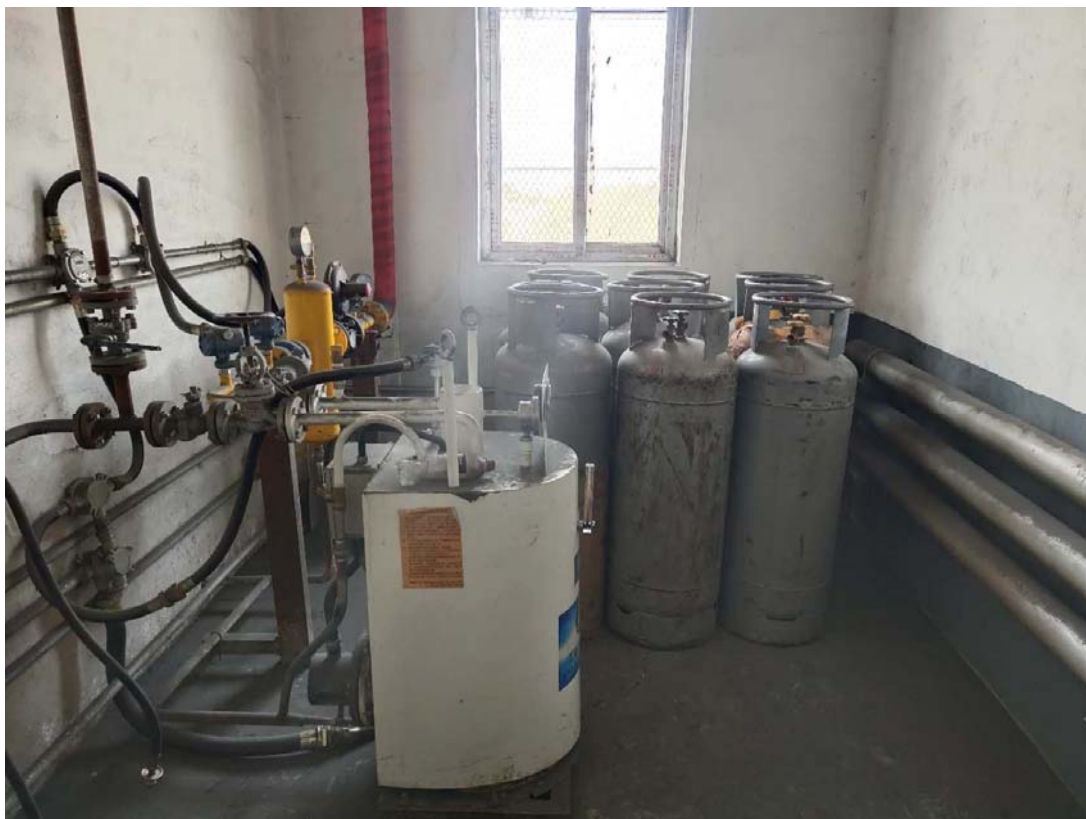
图 4.2-1 点火间内液化气罐照片
