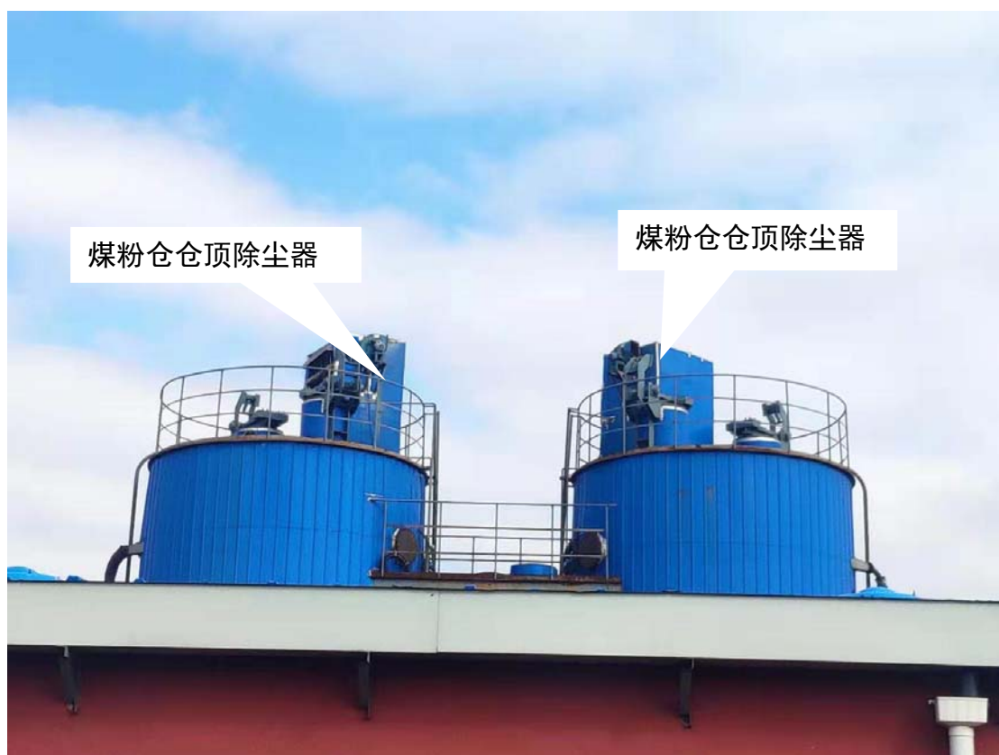
图 4.1-6 煤粉仓仓顶除尘器
