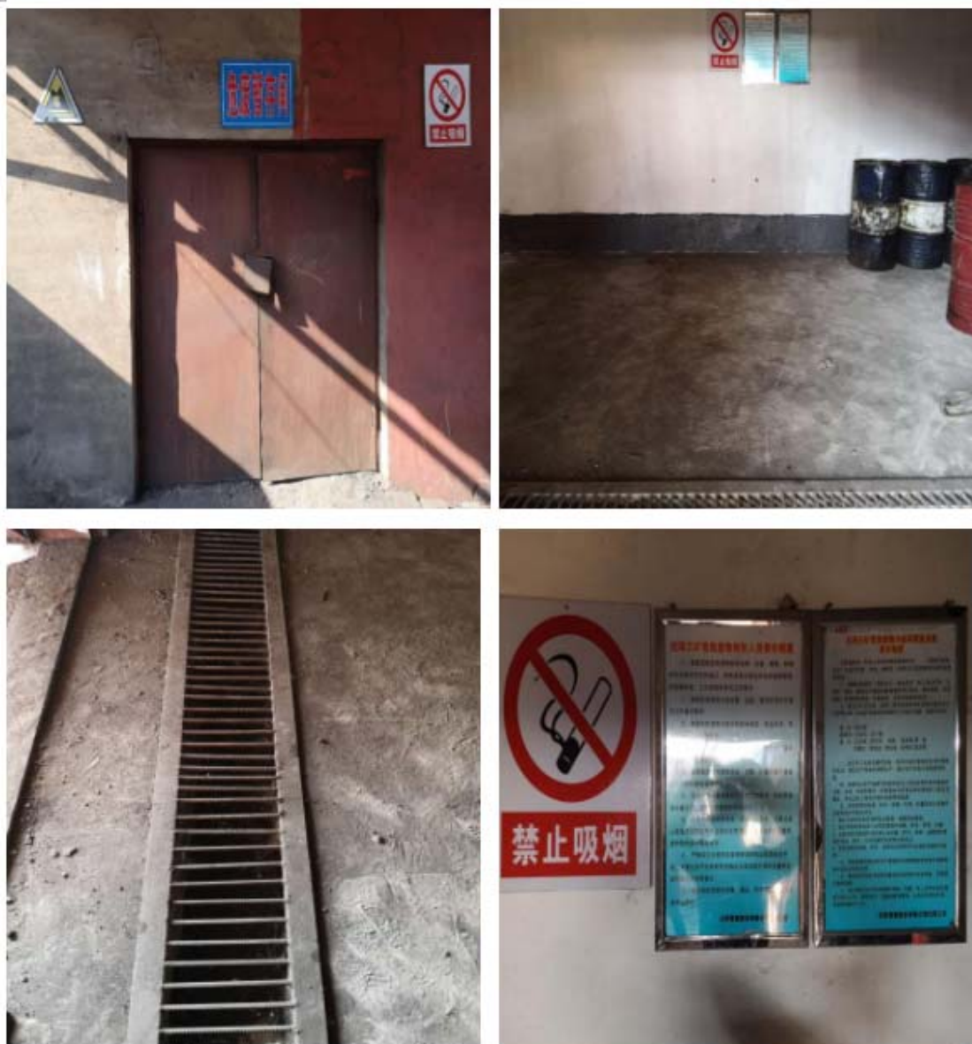
图 4.1-13 红阳三矿全厂危废暂存间（本项目依托）
