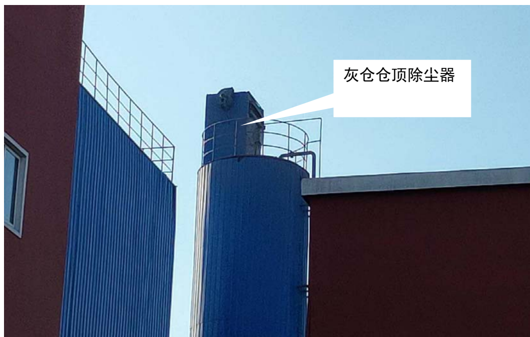
图 4.1-8 灰仓仓顶除尘器
