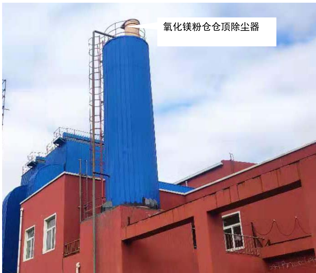
图 4.1-7 氧化镁粉仓仓顶除尘器
