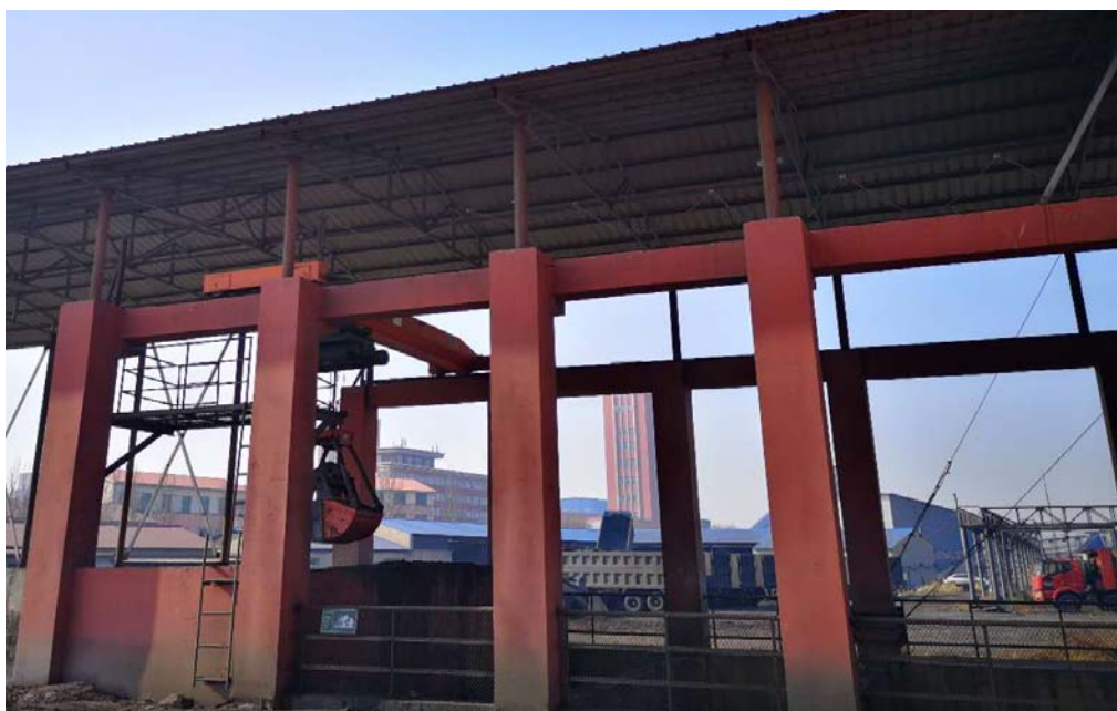
图 4.1-1 现场中和池（脱硫沉淀池）照片
