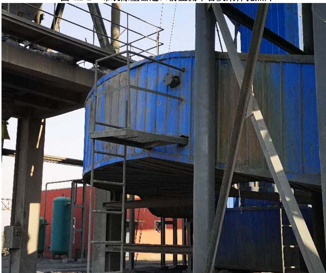
图 4.2-3 脱硫塔进口前监测平台及采样孔照片
