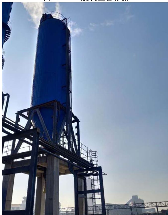
图 4.1-12 粉煤灰暂存仓——灰仓
